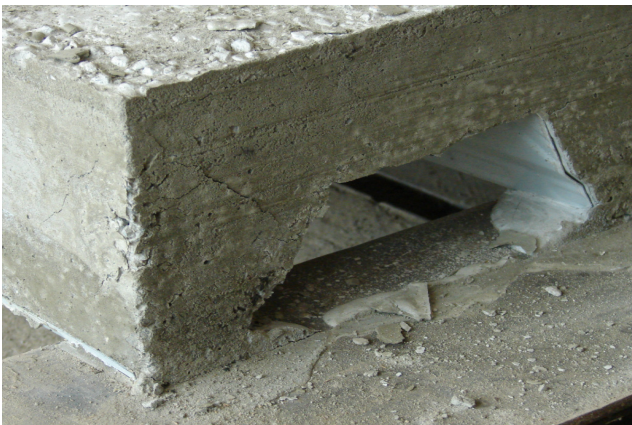
б) разрушение (сдвиг) бетона на опоре
