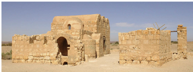
Рис. 1. Серьезные продольные трещины, проходящие через стены дворца Амра (объект всемирного культурного наследия).
