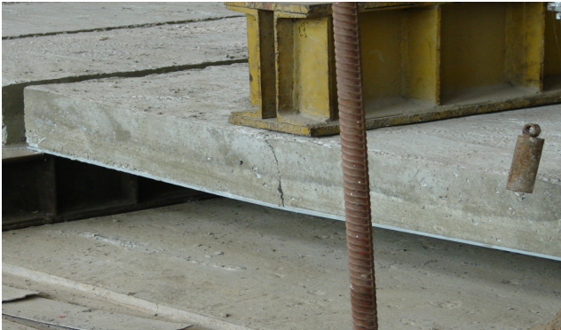
а) разрушение бетона плиты в пролете
