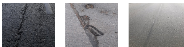
Рис. 1 Состояние шва сопряжения внешних слоев асфальтобетона: А – традиционная укладка после девяти месяцев эксплуатации, Б – итоги санации трещин (после шести месяцев), В – применение стыковочной битумно-полимерной ленты на этапе строительства (после трех лет эксплуатации).
