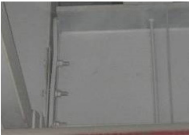
а) грибовидность фланцевого узла соединения балки и колонны перекрытия
